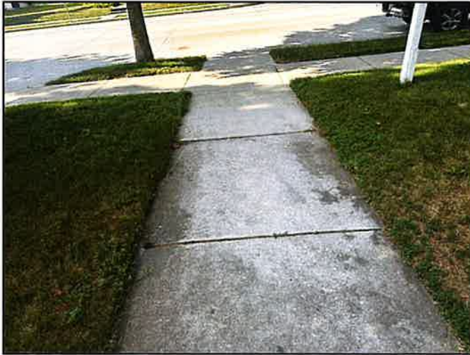
32. Uneven (trip hazard)
