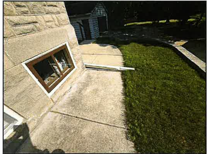
33. Uneven (trip hazard)
