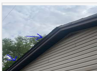
3.7.1.5 Missing drip edge
