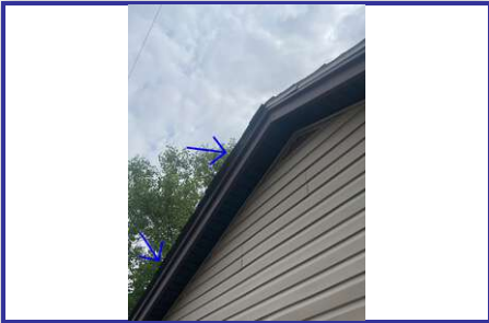
1.3 Missing drip edge
