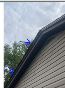
1.3 Missing drip edge
