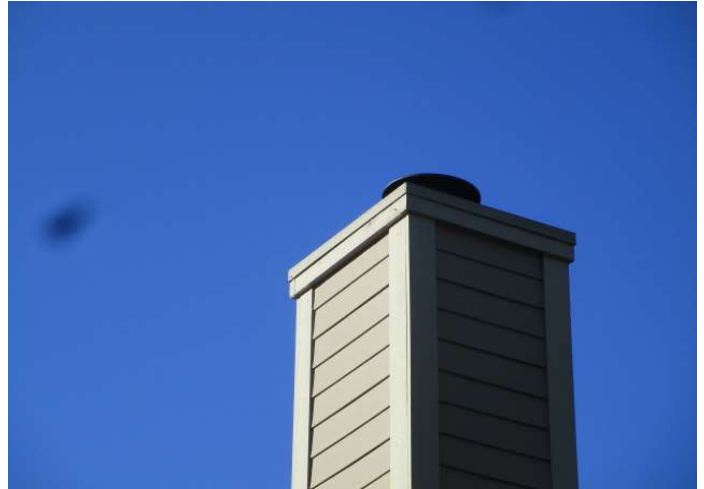
Metal chimney cap
