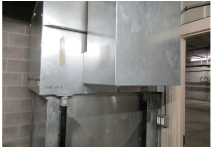
Garage exhaust fan
