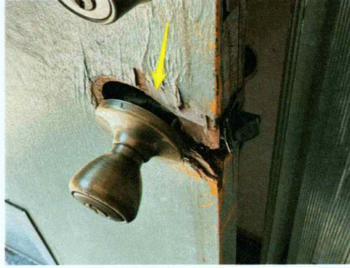
Damaged door knob
