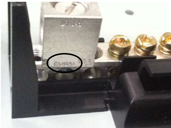
TERMINAL RATED FOR 90°C PER NEC TABLE 310.15(B)(16)
