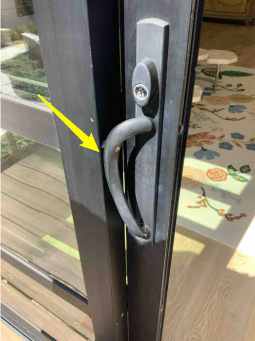
Door handle improperly hits the door frame
