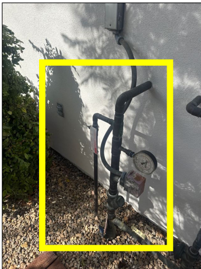
Fire sprinkler riser
