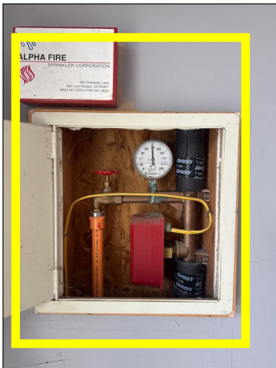
Fire sprinkler riser
