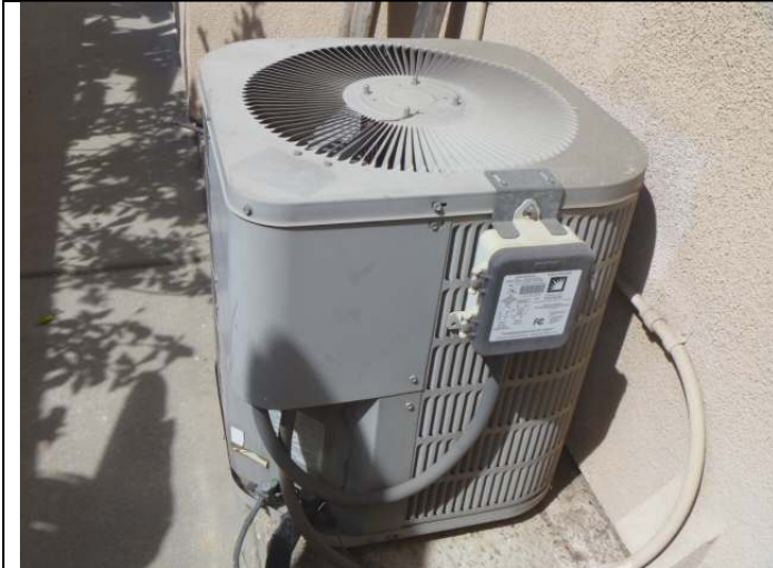
Air conditioner condensing unit.
